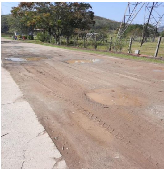
Figura 1: Estado atual do caminho que oferece acesso dos Blocos P ao U.
